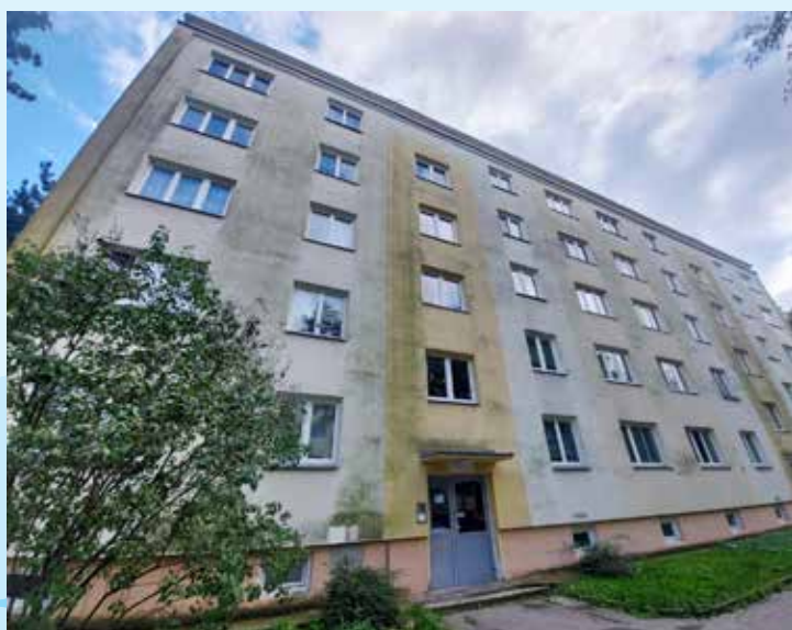
Ťažko znečistená fasáda bytového domu
