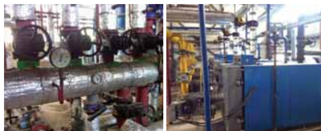
Tepelný zdroj K1 SBD Lučenec – Opatová (pôvodný stav)
