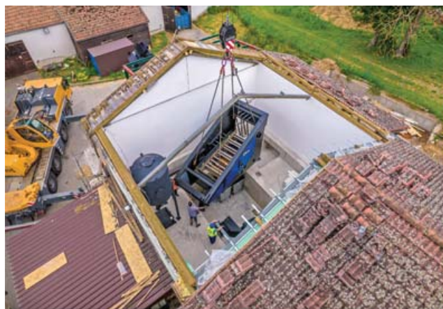
Obr. 2 Kotolňa na biomasu, inštalácia nového biokotla
