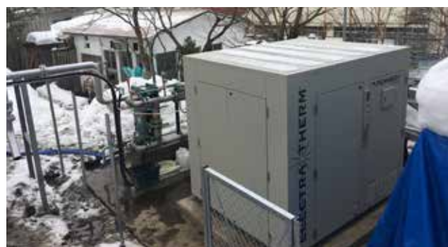
65kW PtG, instalace horkovodního ORC – geothermální vrt – Japonsko
