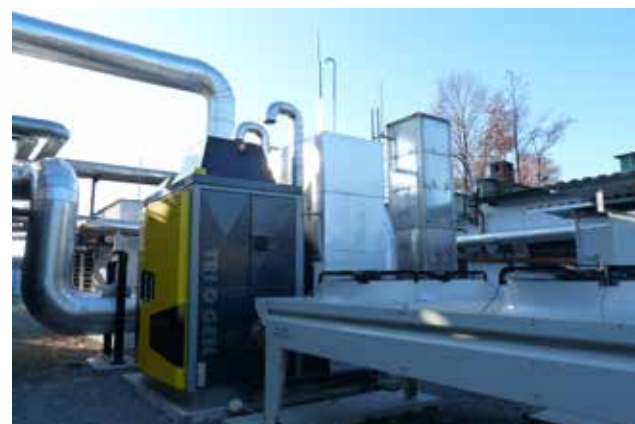
165kW PtG, instalace spalinového ORC v režimu zvýšení účinnosti plynových agregátů – Důl František, Horní Suchá, Česká republika
