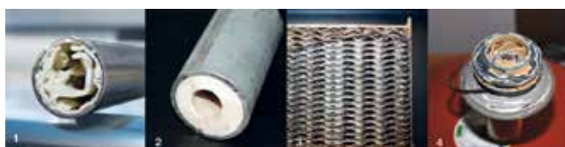
Príklady zanesenia vodným kameňom z praxe 1 – antikorová rúrka 3 – doskový výmenník 2 – pozinkovaná rúrka 4 – cirkulačné čerpadlo
