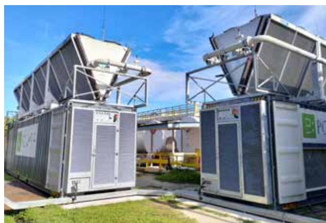
3x 125kW PtG, instalace horkovodního ORC v režimu zvýšení účinnosti dieslových agregátů – Pohnpei, Mikronésie:
