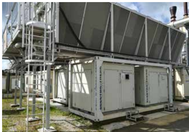
4x 65kW PtG, instalace horkovodního ORC v režimu využití odpadního tepla – Veolia Francie:
