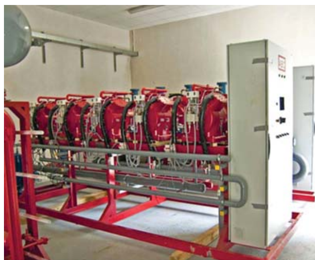
TČ s výkonom 2x250 kW
