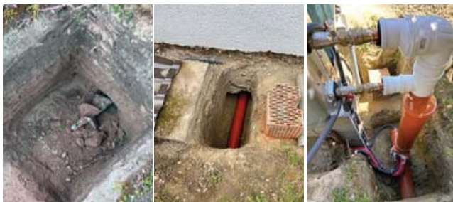
Obr. 2 Závitovica z pivnice vchádza do jamy za TČ. V strede rúra popod základy RD. Napravo privádza k vonkajšej jednotke tepelného čerpadla rúrky, káble.
