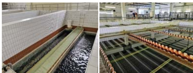
Obr. 3 Úpravňa vody Turček, pohľad na filtre vľavo a lamelové usadzovacie nádrže vpravo
