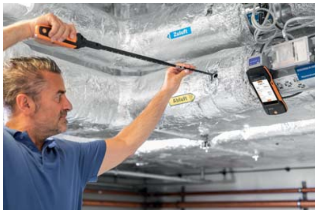
Obr. 1 Měření objemového průtoku ve vzduchotechnickém potrubí s testo 400
