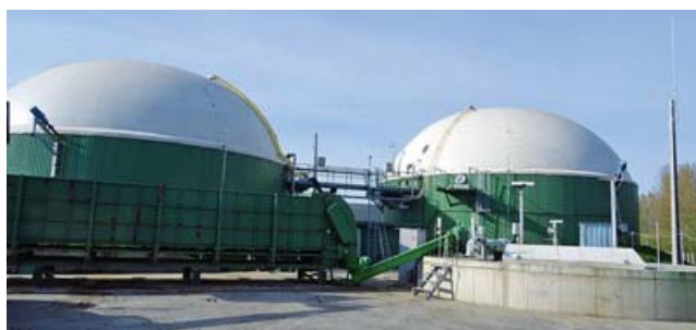
Obr. 2 Pohľad na typickú BPS s inštalovaným elektrickým výkonom 1 MW (fotografia autor)
