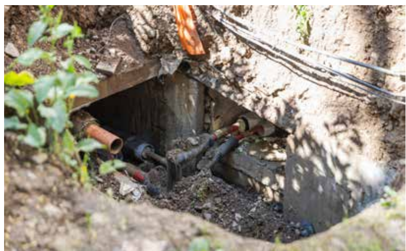
Obr. 2 – otvorený teplovodný kanál s pôvodným klasickým rozvodom a novým potrubím NRG HeatFlex
