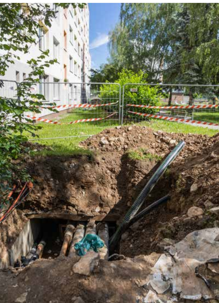
Obr. 1 – otvorený teplovodný kanál s pôvodným klasickým rozvodom a novým potrubím NRG HeatFlex
